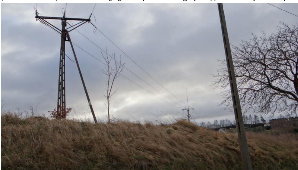
Zdjęcie nr 4. Obszar opracowania – napowietrzna linia elektroenergetyczna średniego napięcia.
